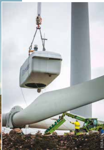
Lors du repowering du parc éolien de Cham Longe, à Saint-Étienne-de-Lugdarès et Astet, dans l'Ardèche, Boralex a pu augmenter la puissance de 23 à 40 MW.
