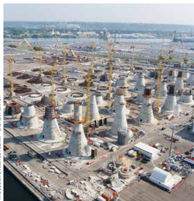
PARC ÉOLIEN EN MER DE FÉCAMP - LAURENT CRITOT
